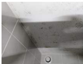
Défaut de fonctionnement des VMC
